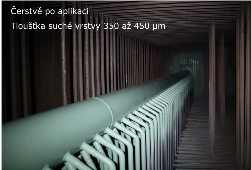
Komora ekonomizéru v zadním tahu hnědouhelného kotle
